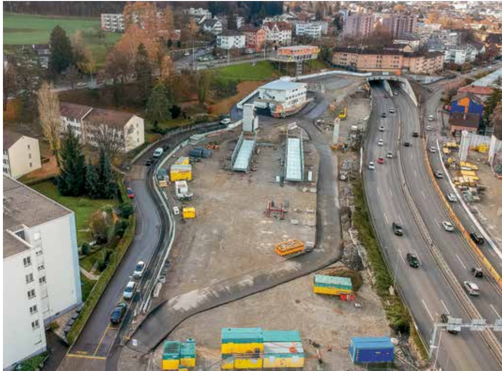
Am Platz dieser Grossbaustelle, neben dem geplanten Hochpark, soll einst der Ersatzneubau Tulpenweg stehen.
